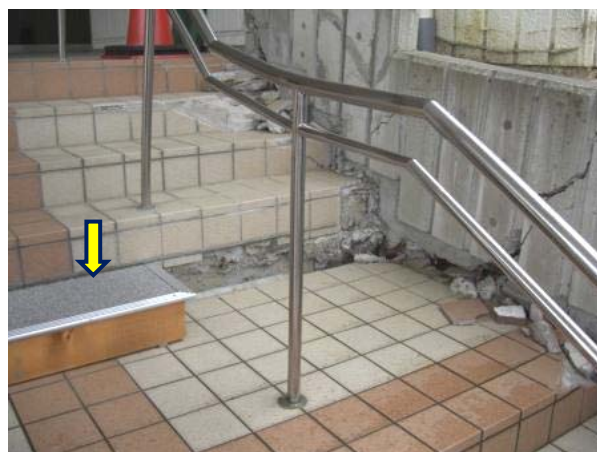
図24—市役所の入り口の階段。地震動でずれてしまい、踏み段(⇒)をかませて高さを調整している
