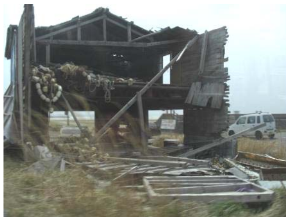
図16—国道6号線沿いの津波で全壊した家
